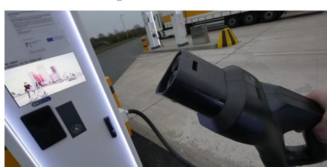
Der Lkw-Megawatt-Charger auf dem Rasthof „Lipperland Süd“ an der A2 – auf dem ehemaligen Reisebus-Parkplatz.
